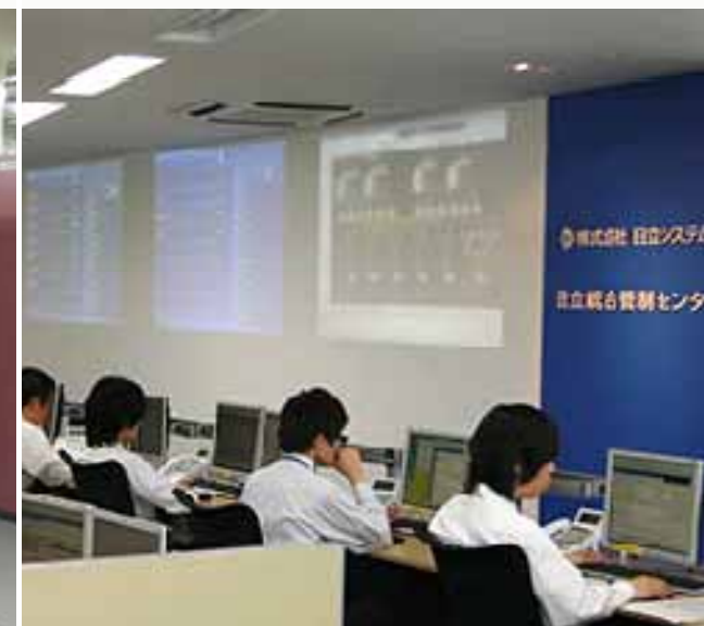
統合管制センター
